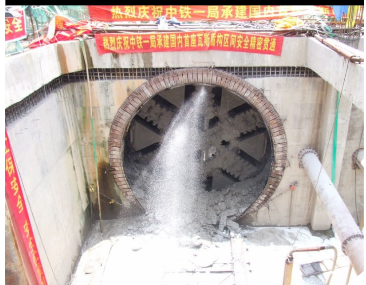
LIGNE 2 DU METRO DE WUHAN : Breakthrough du tunnelier NFM Technologies le 19 juin 2009 (Lire la brève page 4)
